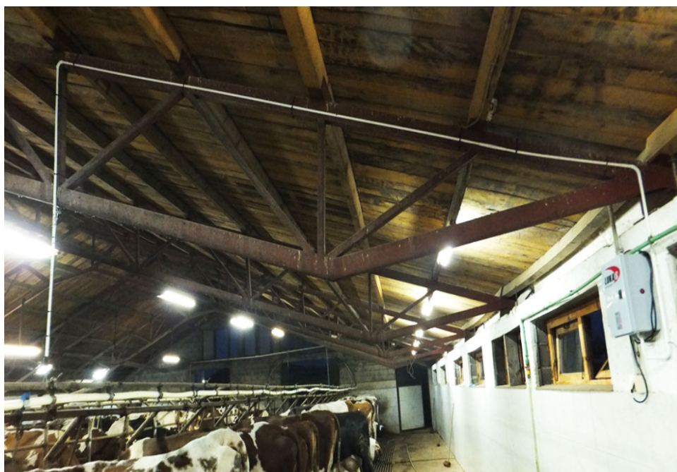
Slika 17. Instalacija StallWeather sistema u staji
