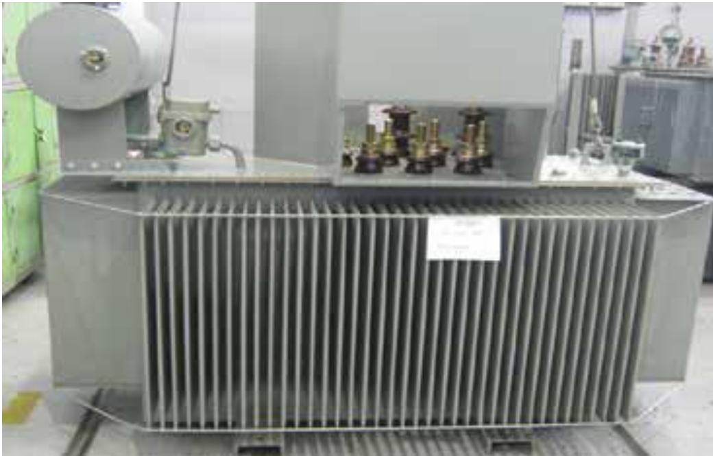
Slika 3. Izgled transformatora 10/0,4 kV,630 KVA
