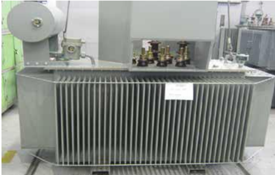
Slika 3. Izgled transformatora 10/0,4 kV,630 KVA
